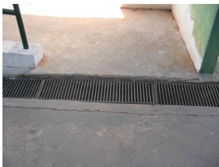
Figura II – Detalhe da grelha, instalação inadequada EMEIF Antônio Moreira Lima.
