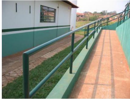
Figura III - Detalhe do corrimão de entrada do primeiro e segundo segmento da EMEIF Rosana Negrão
