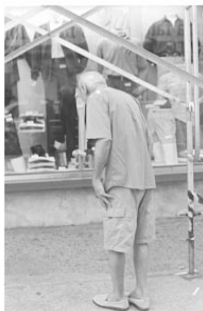
Figura 9: Obras na calçada da rua Figueiredo de Magalhães, sem proteção para a cabeça dos pedestres.. Fonte: MENDES, abr. 2006
