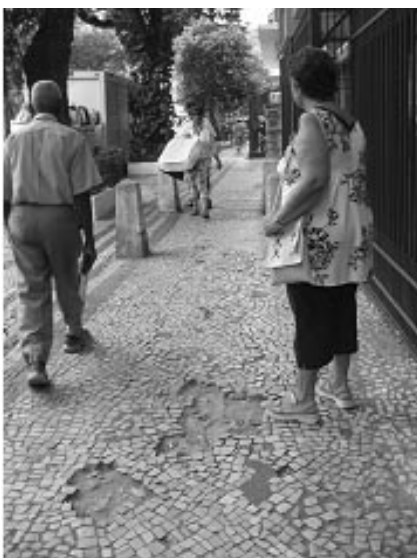
Figura 13: calçada esburacada no caminho da idosa. Rua Barata Ribeiro perto da estação do Metrô Arcoverde. Fonte: MENDES, mar. 2007.
