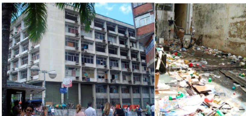
Figura 1: fachada e área interna do antigo prédio do IPASE Fonte: Barbosa & Medeiros (2008)
